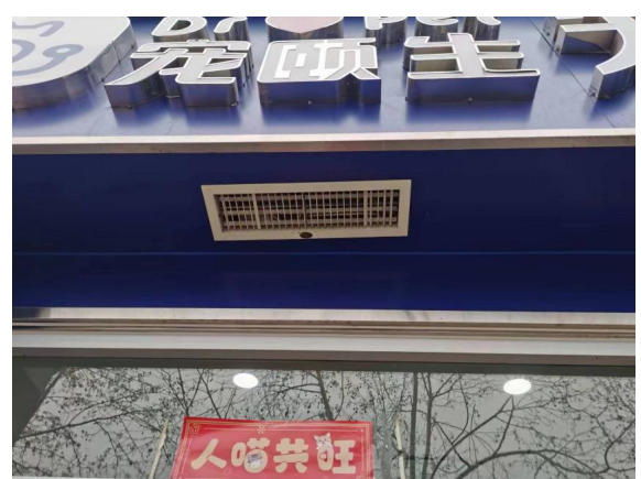
图 4 总排气口位于房外，朝向颍上路
