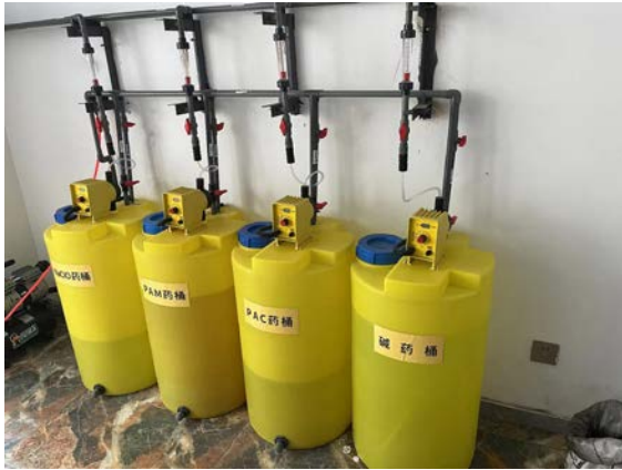
图 1 一体化污水处理设备加药罐（TW001）
